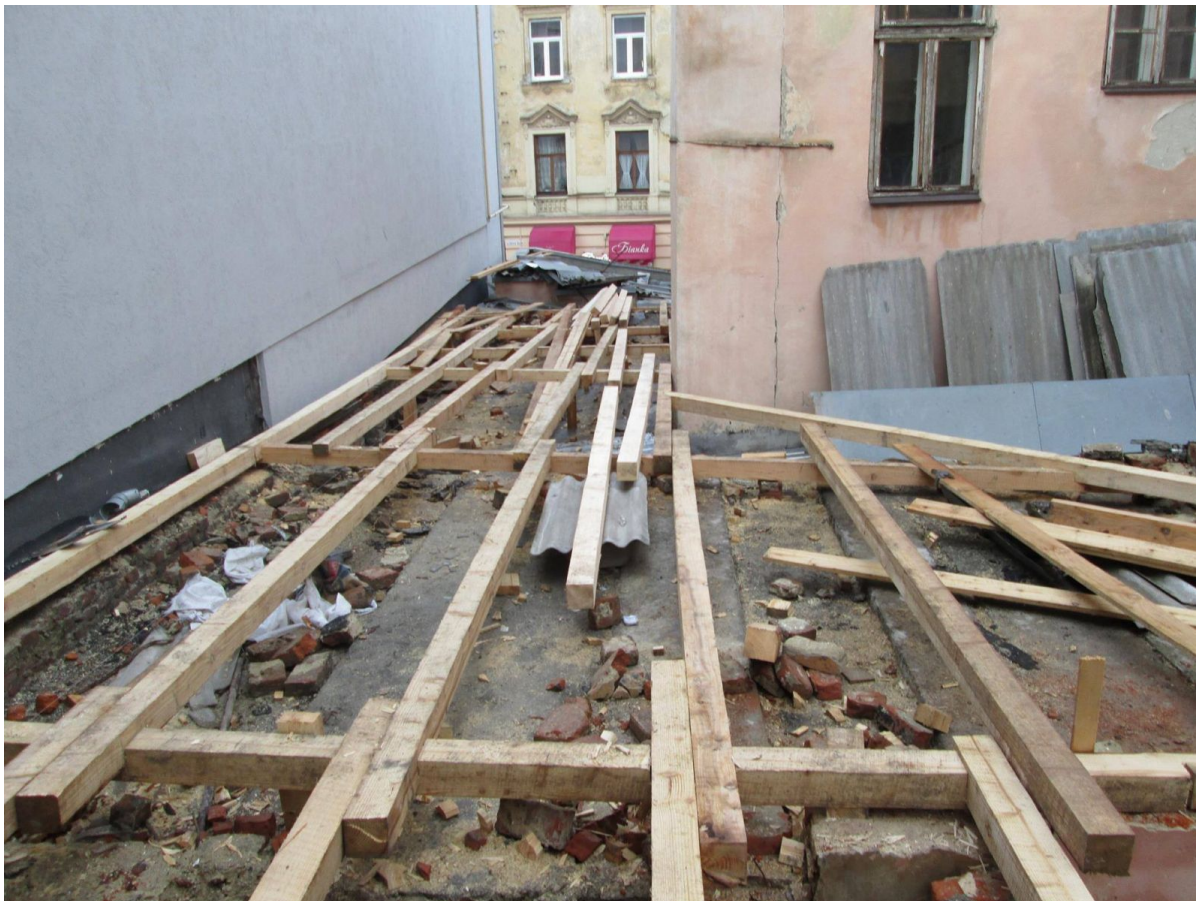
Крыша здания после урагана
